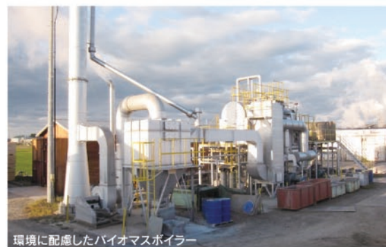
環境に配慮したバイオマスボイラー
